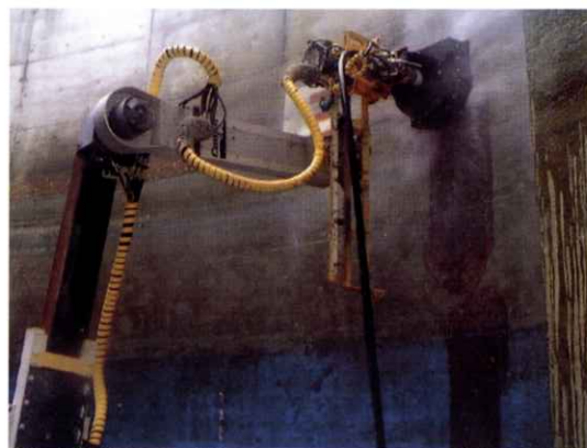
壁面塗膜剥離
